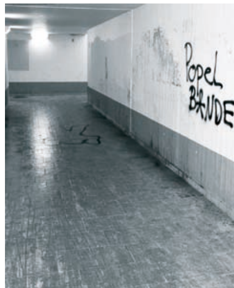
Bahnhofs-Aktion des „Freien Netzes“ in Bad Lausick: Der Bahnhofstunnel wurde blutrot beschmiert, in der Mitte die Silhouette eines Toten aufgemalt – offenbar ein Hinweis auf den berüchtigten „Volkstod“.
